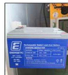
แบตเตอรี่สำรอง ตู้ไม้กั้นทำงานแม้ขณะไฟดับ
